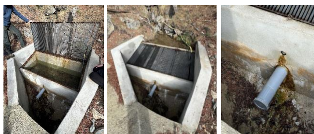
Figure 25 : Photos de l'infrastructure de captage du canal sur la piste forestière
